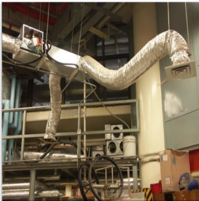
3. ábra: Az HVAC laboratórium egy részlete
