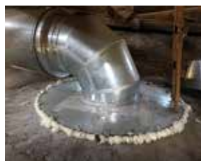
Főkupola szellőző rácsára ráépített elszívó rendszer
