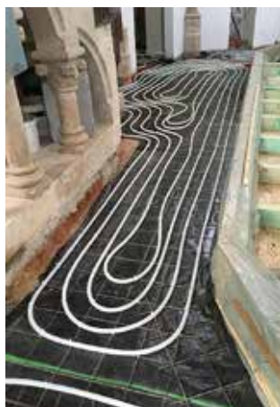
Padlófűtés csövezése a közlekedő térben
