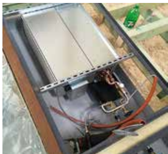
Fancoil elhelyezése a padok dobogói alatt
