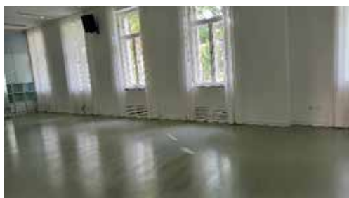
Fan-Coil burkolatok a parapetekben
