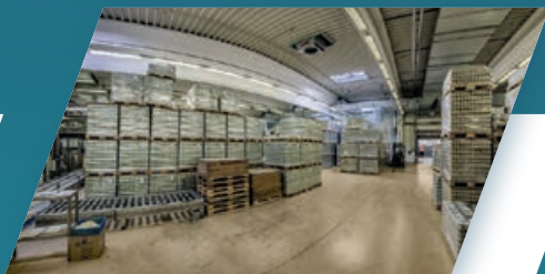
HIPP – HIPP Magyarország Kft – gyártócsarnok hőszivattyús hűtés-fűtés
